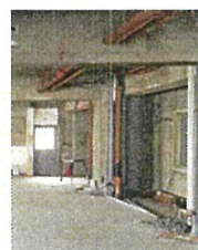
居室内にダクトが貫通している例
