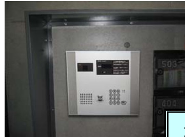
新設集合玄関（カメラあり）
