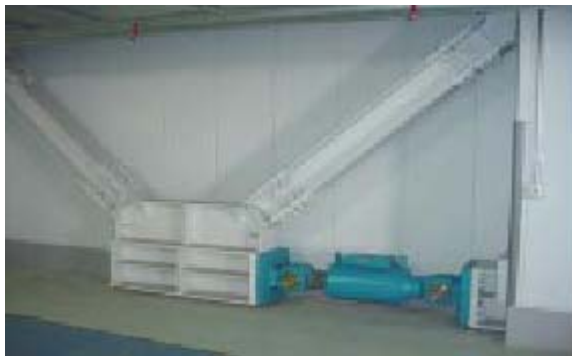
オイルダンパーの設置状況
