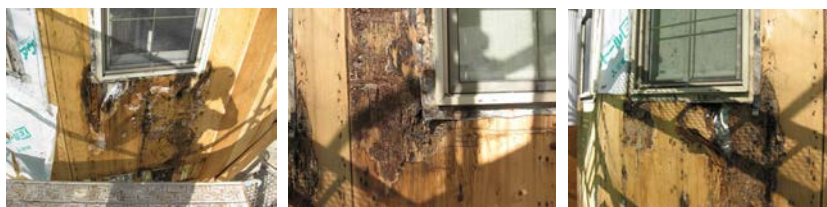
外壁表面仕上材を剥した被害状況
