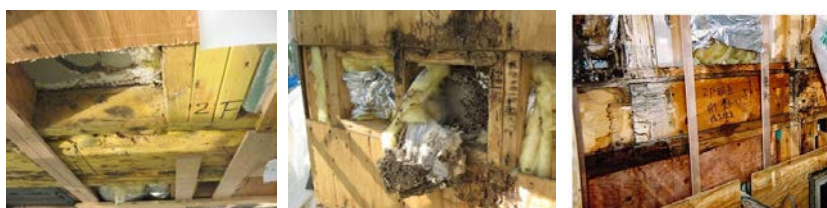
構造用合板撤去後の壁体内被害状況
