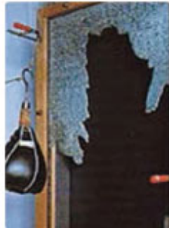
強化ガラス (5mm) 破損すると、ガラスが飛散して加撃物が貫通。
